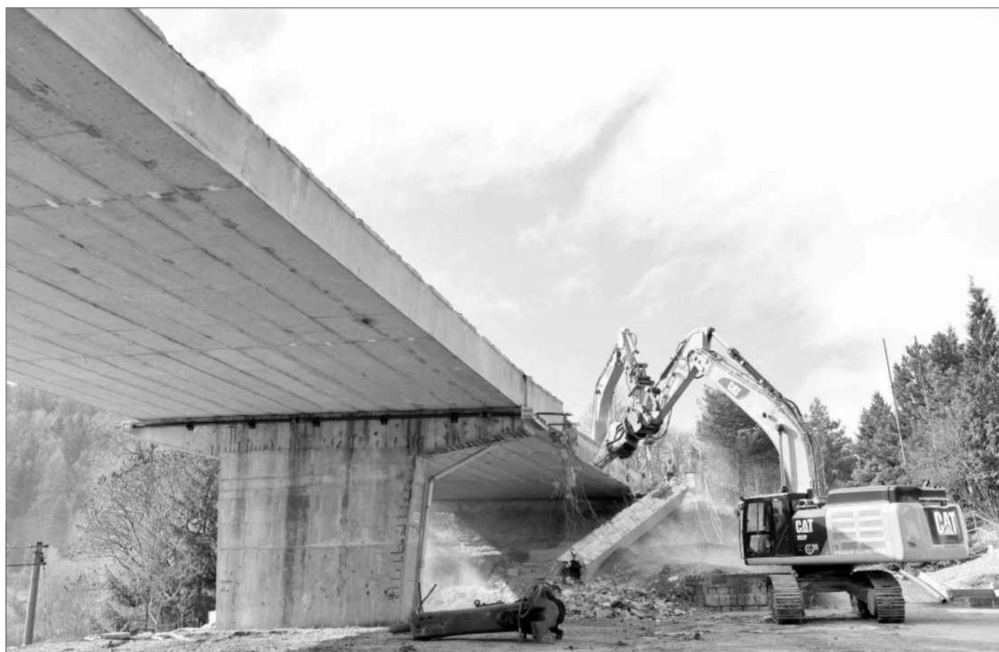
Dělníci začali včera rozebírat most na silnici I/43 u Černé Hory na Blanensku. Konstrukce by měla zmizet během dubna a do konce roku má stát nový most, který znovu po více než roce odvede tranzitní dopravu z měststve na obchvat. Cena za demolici a stavbu je 53 milionů korun.
